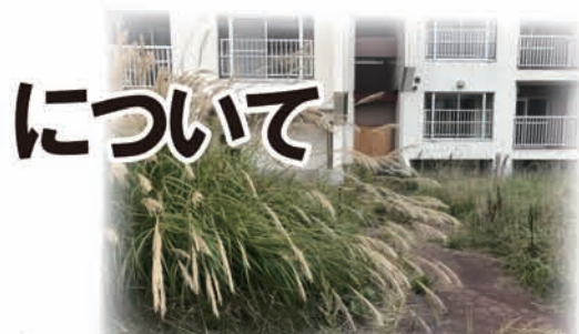
すでに入居者がいなくなった階段入り口では、草が生い茂る状況に
